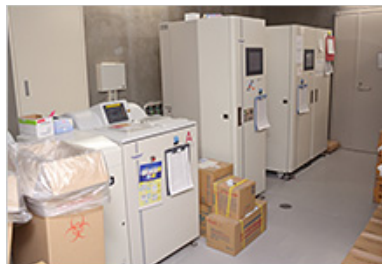
清潔に管理された機械室
